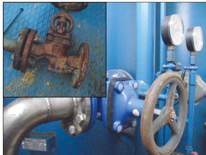
Obecný vodojem by potreboval kompletnú rekonštrukciu. V marci prebehli aspoň nutné výmeny zhrdzavených ventilov.
