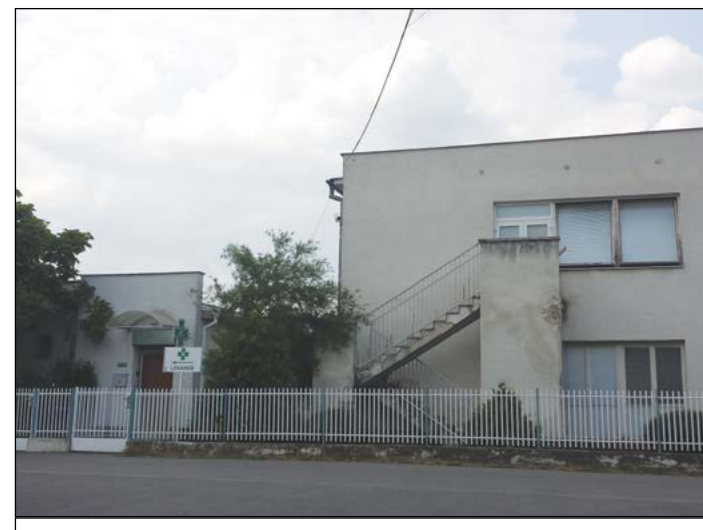
Nadstavba materskej školy sa z dôvodu popraskaných múrov musela podrobiť novému statickému posudku a novým plánom. Začiatok nadstavby september – október 2013.
