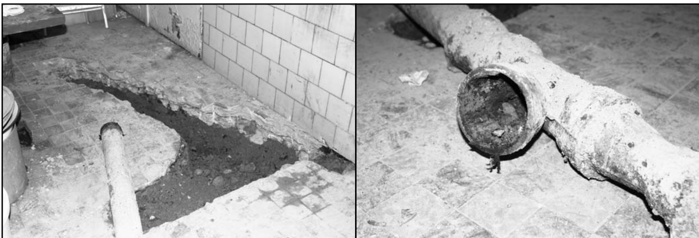
Staré odpadové potrubie v kuchyni, ktoré bolo upchaté hlavne sócom z kávy.
